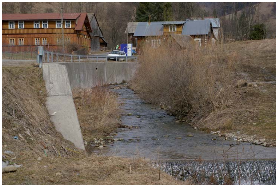
Rys. 6. Mur oporowy lewego brzegu potoku Jamne Fig 6. Concrete wall left bank of Jamne stream
