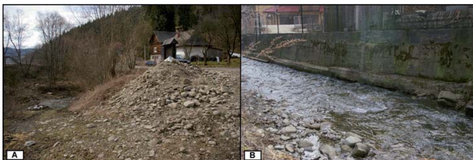
Rys. 5. Otoczaki pobrane z koryta potoku Jamne (A) i podmyty mur oporowy w ujściowym odcinku potoku (B)
