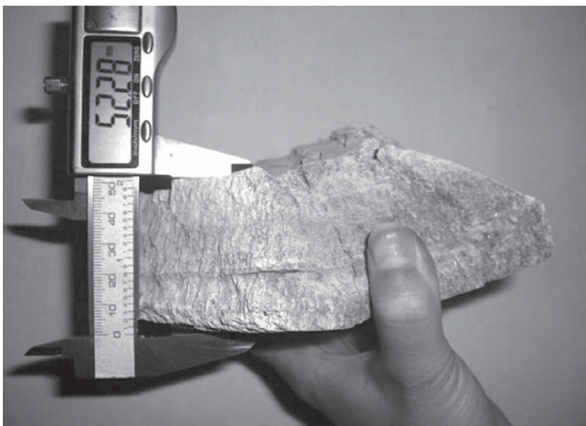
Rys. 1. Widok z boku na struwit wykrystalizowany w rurociągach oczyszczalni ścieków w Łodzi Fig. 1. Side view of the crystallized struvite in pipes of sewage treatment plant in Łódź
