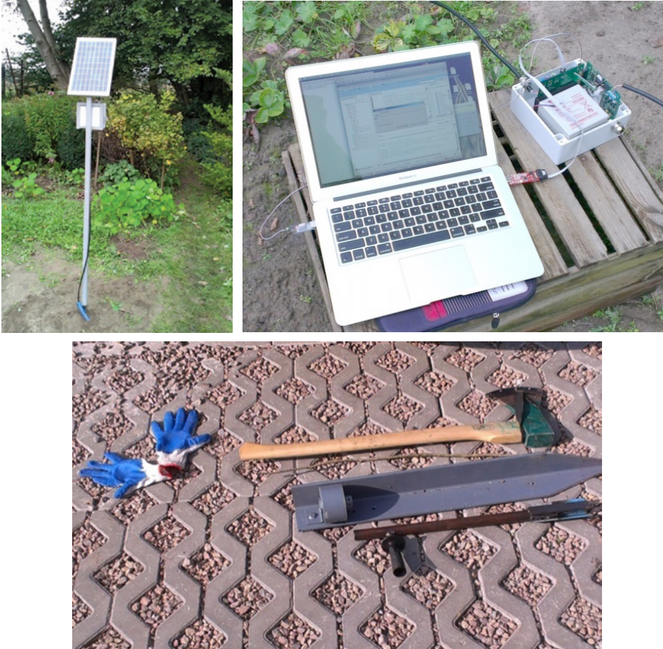
Ryc. 1. Automatyczna stacja wodowskazowa w Batowicach: a) maszt z panelem solarnym i skrzynką z modułami elektronicznymi, b) instalacja oprogramowania do modułów sterowania w skrzynce stacji, c) pal (ceownik stalowy) z zamontowanym czujnikiem ciśnienia – przed wbiciem w dno Dłubni
