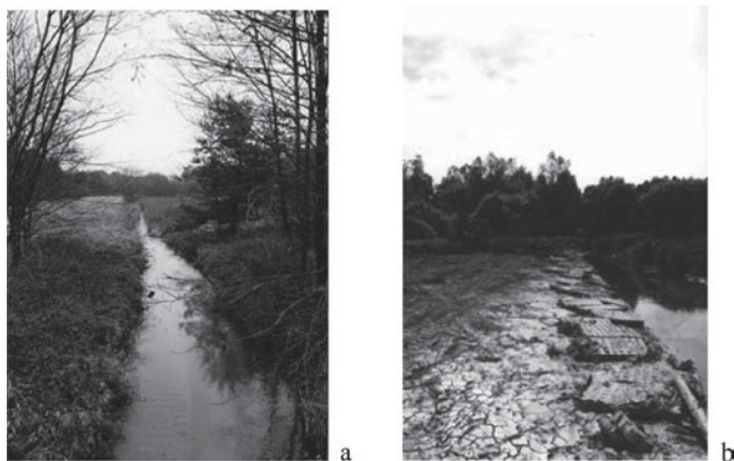
Rys. 2. Odcinek wyprostowanego koryta rzeki Förritz z roku 2000 (a) oraz zniszczone umocnienia brzegowe (b) [TMLNU 1996]
