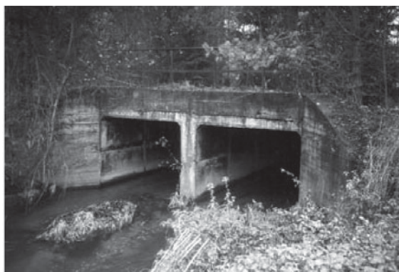
Rys. 3. Częściowo zaszutrowany przepust na rzece Föritz [TMLNU 1996]
